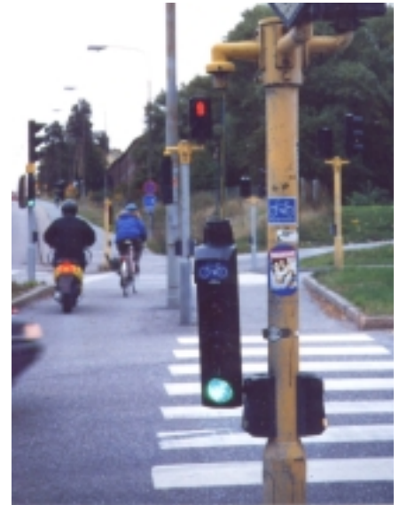
En låg cykelsignal blir lätt hängande i sina kablar. Främst beroende på att cyklister använder dem som "handtag" när de väntar på grön signal. Den infästning som används i Stockholms stad håller inte för detta. Andra städer har bättre lösningar
